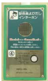
駅係員呼出インターホン▶
