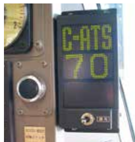
▲C-ATS運転台の表示器
