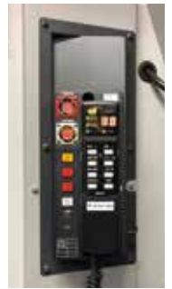
▲列車無線装置
