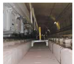
▲限界支障検知器
